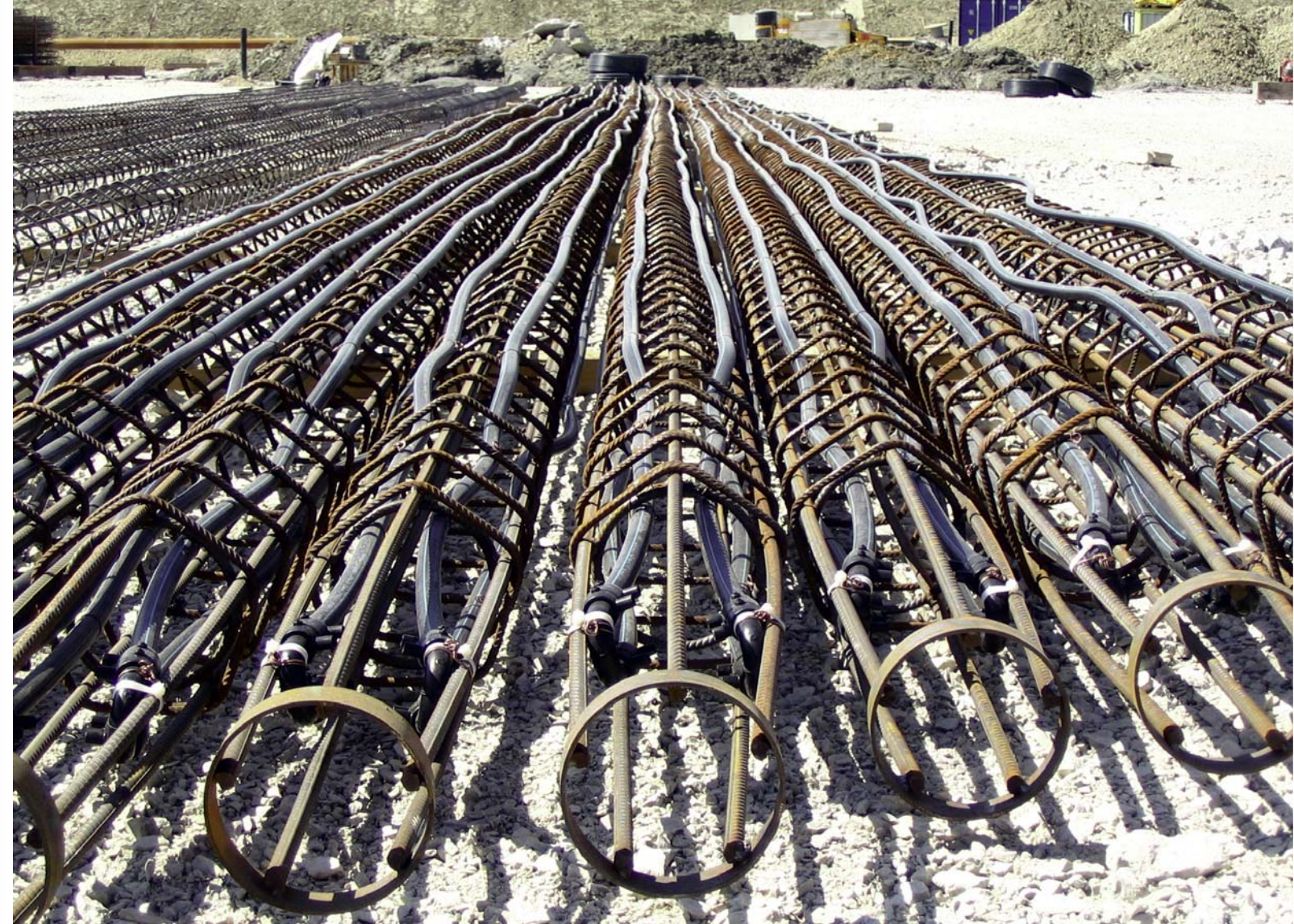
Vorbereitete Stahl-Armierungen für die Betonpiloten waagrecht vormontiert. 420 Piloten werden 24 m tief in Ortbeton vergossen, 110 Stück mit Rohrleitungen als Erdenergiepfähle ausgerüstet. Gesamtlänge der Rohrleitungen unter der Erde = 10.000 lfm.
